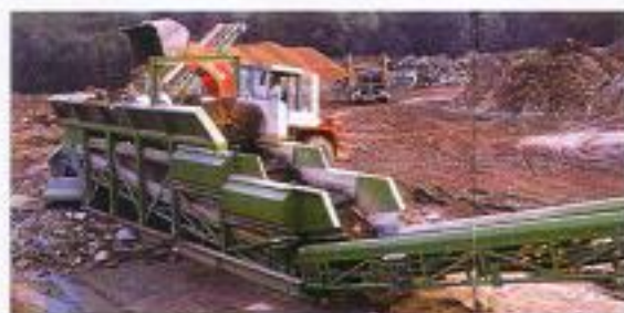
Tolva con piso móvil y criba integrada en planta de clasificación y limpieza de escombros
